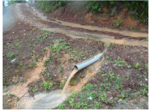
大小堀河口 大規模造成裸地からの濁水流出 (今年度)
