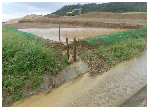
大浦川河口 広域探査発掘加速化事業地からの濁水流出(今年度)
