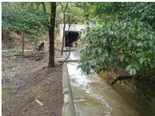
加武川河口 基地内からの濁水(今年度)
