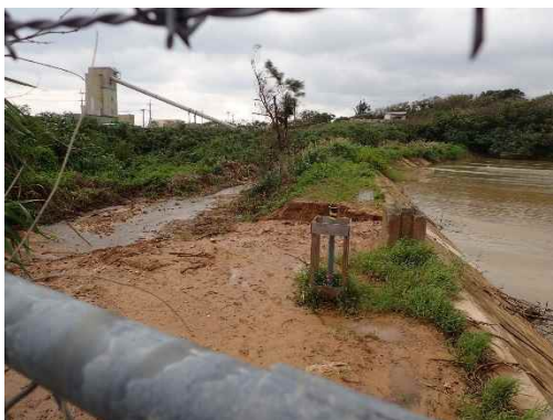
野崎川河口 沈砂池に濁水および土砂が堆積 (今年度)
