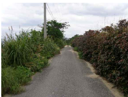
地点⑦ 道路への流出痕(変化無し)
