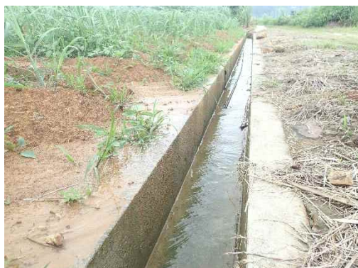
地点⑫ 畑から側溝への赤土流出痕
