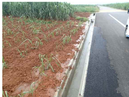
地点⑬ 畑から側溝への赤土流出痕
