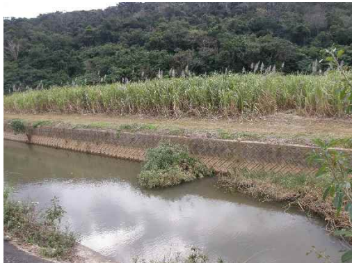
地点⑤ 河川そばの畑(流出痕有り)
