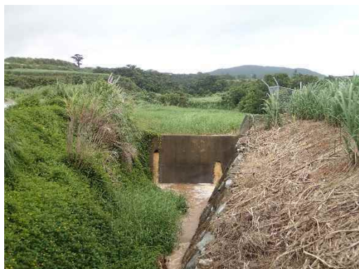
地点⑦ 沈砂池からの濁水流出
