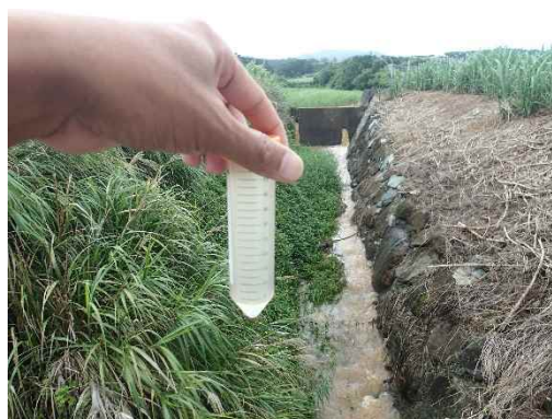
地点⑦ 沈砂池から流出した濁水の濁度
