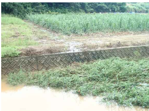
地点⑤ 河川そばの畑(流出痕有り)
