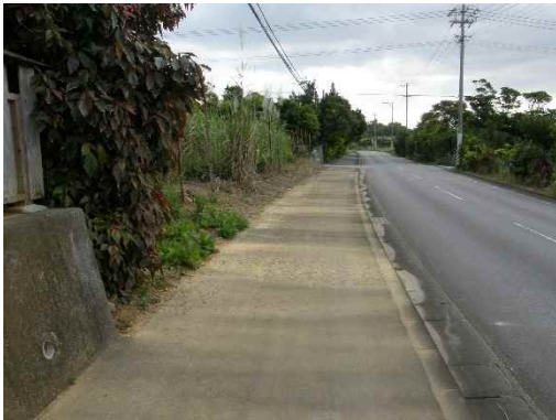
地点② 道路及び側溝への赤土流出痕(変化無し)
