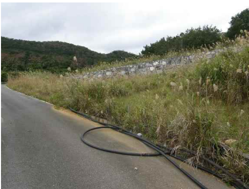
地点⑤ 道路に赤土流出痕有り(変化無し)
