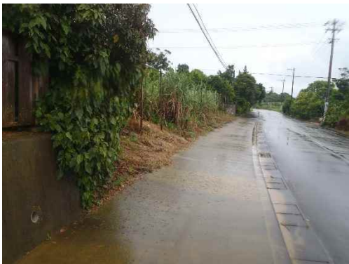
地点② 道路及び側溝への赤土流出
