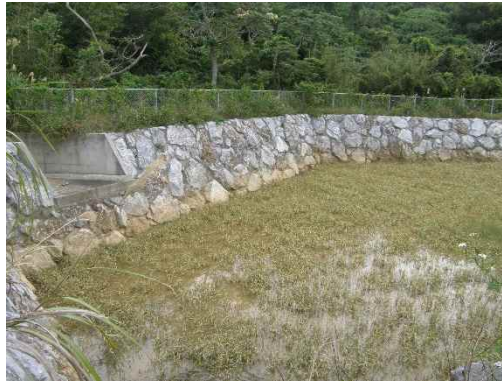
地点⑦ 中流域にある沈砂池
