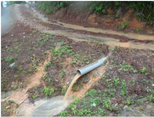
地点④ 周辺裸地からの赤土流出
