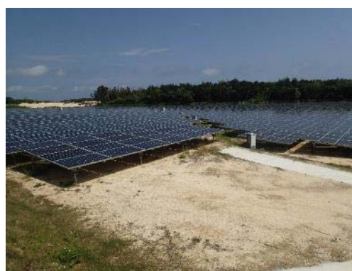
地点 太陽光パネルの状況
