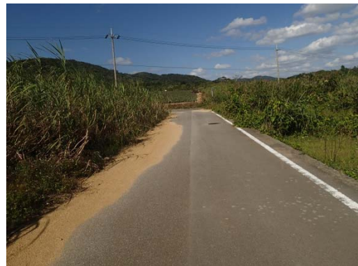
地点 道路への流出痕
