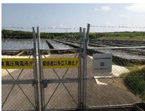
地点 太陽光発電設備状況
