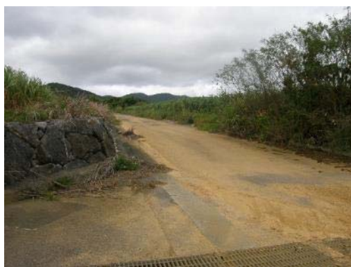
地点 道路への流出痕
