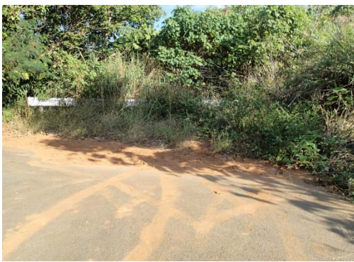
地点 道路への流出状況
