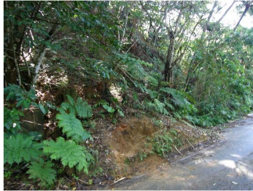
地点 土砂崩れの状況(溝を越え道路まで流れている)
