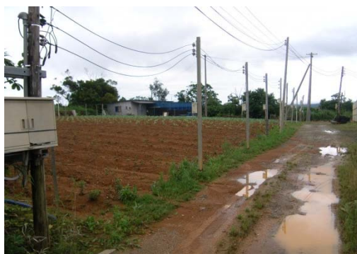
地点 前回確認流出箇所
