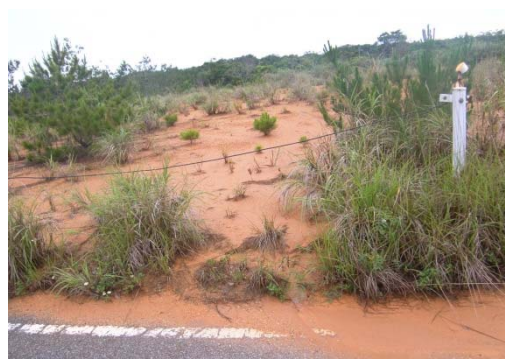
地点 前回確認流出箇所
