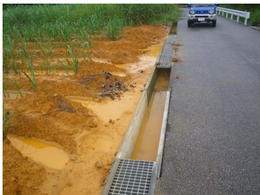
地点 改善状況
