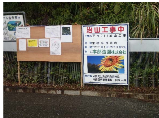
地点◎ 土砂崩れ箇所対策看板
