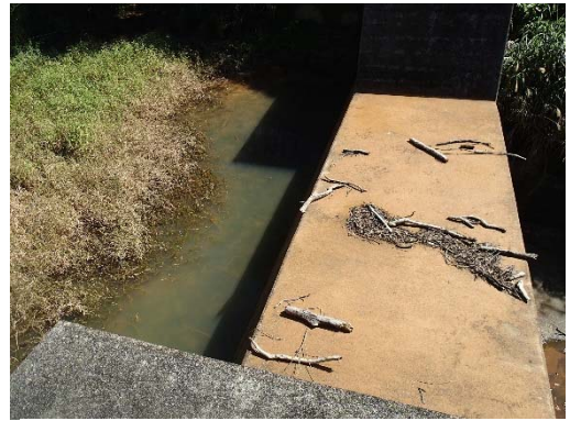
地点 砂防ダム越流(直上に堆積土砂あり)
