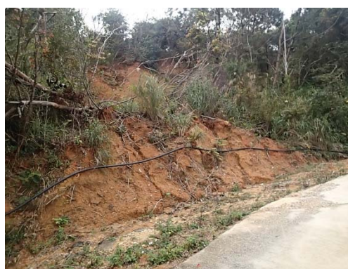
地点 がけ崩れ後の状況
