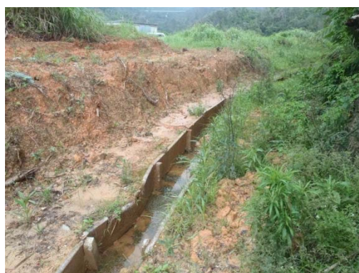
地点 造成水路横の裸地
