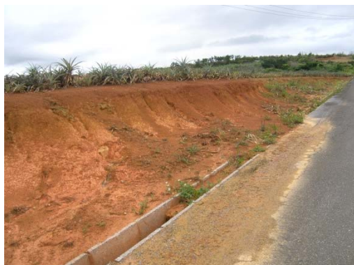
地点 道路への流出痕
