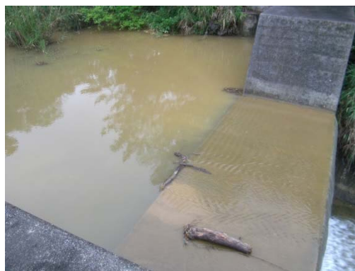
地点 砂防ダム越流(直上に堆積土砂あり)
