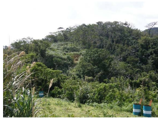
地点 造成に伴う土砂崩れ箇所(第1回目地点 )
