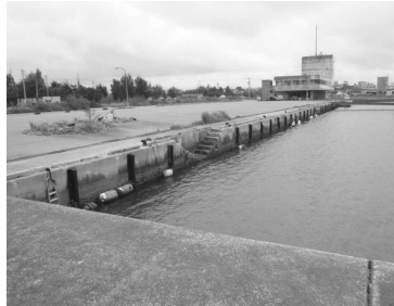
地震に対して脆弱な岸壁
