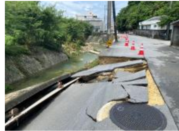
●北谷町吉原道路決壊 ・北谷町吉原で白比川氾濫し、北谷町吉原の道路が決壊 ※写真は、沖縄県秘書課提供
