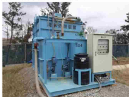
写真8 濁水凝集処理装置
