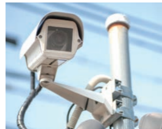
Cámaras de seguridad instaladas
