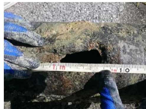
配水管の腐食
