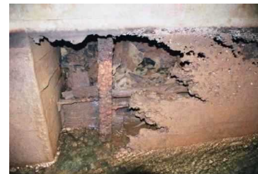
導水路内部の劣化
