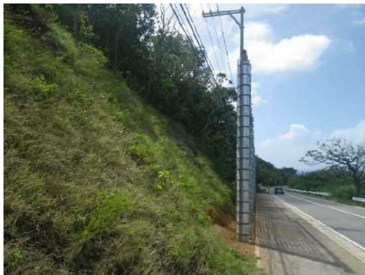
落石対策済みの道路を安全に通行する車両 (石垣港伊原間線)
