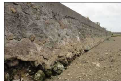
護岸基礎が老朽化により崩壊
