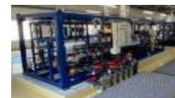
海水淡水化施設
