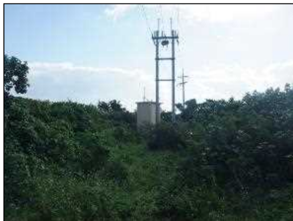
写真㉕ 海底ケーブル立ち上がり
