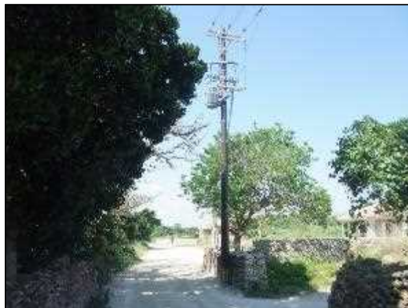
写真㊹ 高圧線端 3
