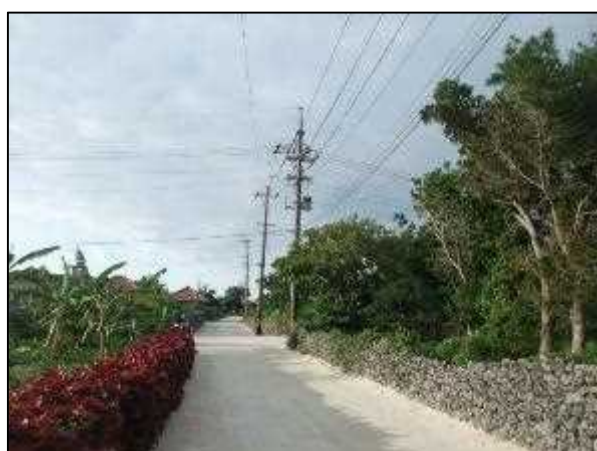
写真㊴ 高圧線分岐 2
