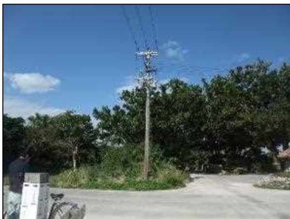
写真㊺ 高圧線分岐 7
