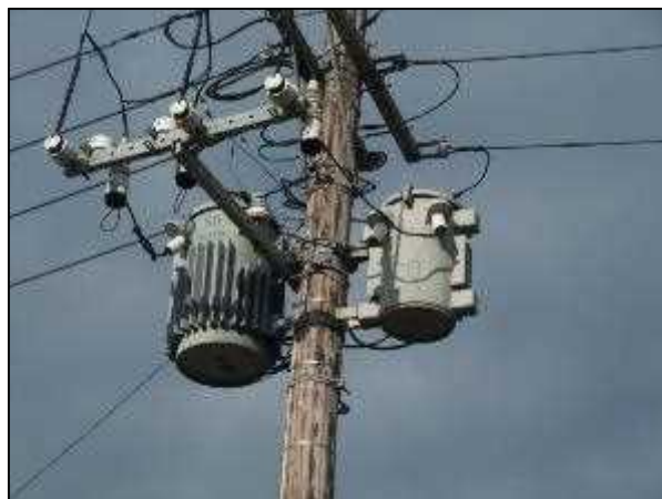
写真㊧ 柱上トランス 1
