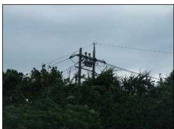
写真⑫ 海底ケーブル立ち上がり
