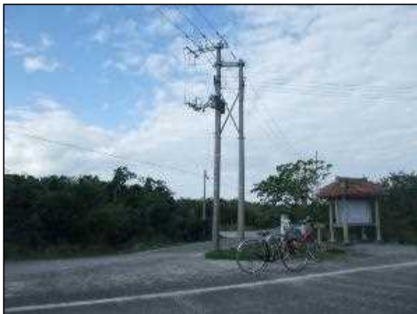
写真④ 高圧線分岐 4
