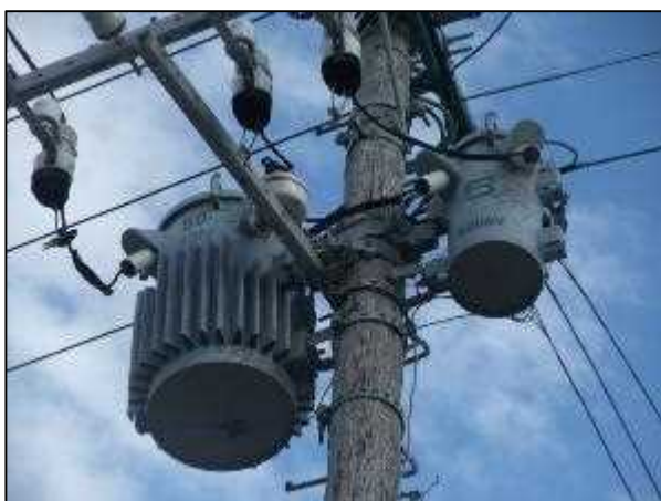
写真㊪ 柱上トランス 2
