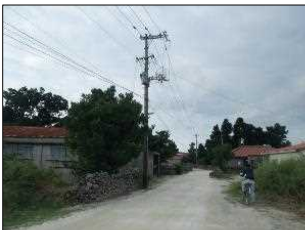
写真㊳ 高圧線ルート 3
