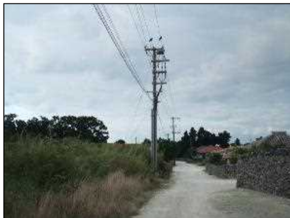
写真㊲ 高圧線埋設部 1
