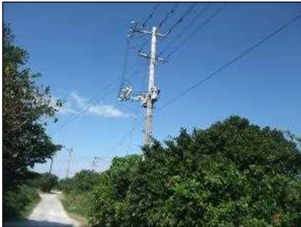
写真㊨ 高圧線端 1
