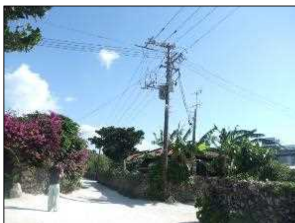
写真㊽ 高圧線ルート 13
