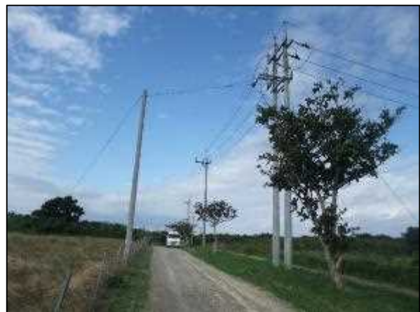
写真⑥ 高圧線ルート 1
