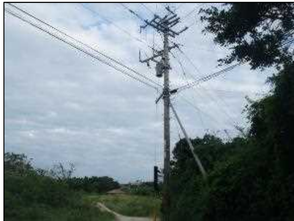
写真㉟ 高圧線分岐 1
