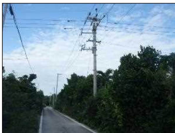
写真⑦ 高圧線分岐 5
