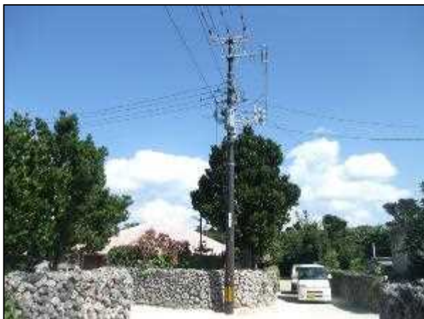
写真㊸ 高圧線端 2
