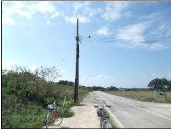
写真㉞ 高圧線埋設部 6
