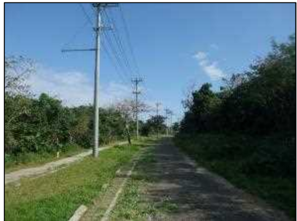
写真⑩ 高圧線ルート 4
