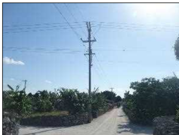
写真㊼ 高圧線分岐 8
