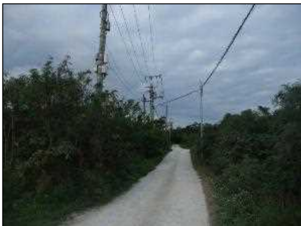
写真㉞ 高圧線ルート 1
