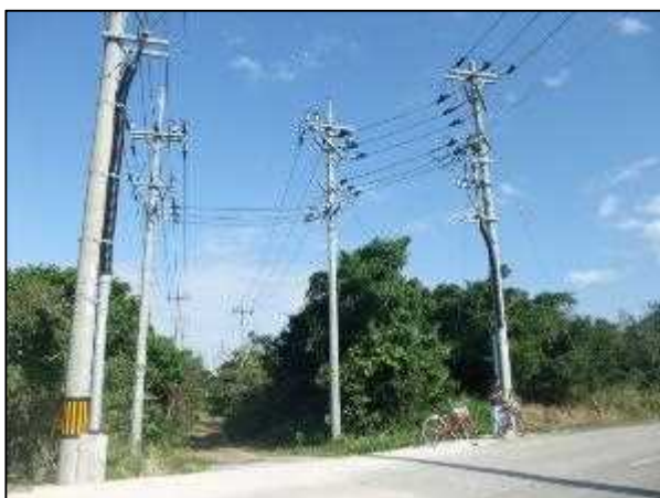
写真㉘ 高圧線分岐 6
