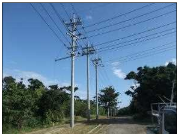
写真⑨ 高圧線分岐 1
