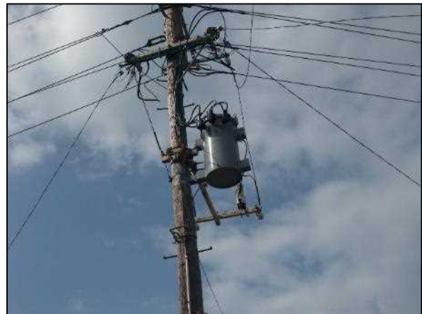
写真⑥ 柱上トランス
