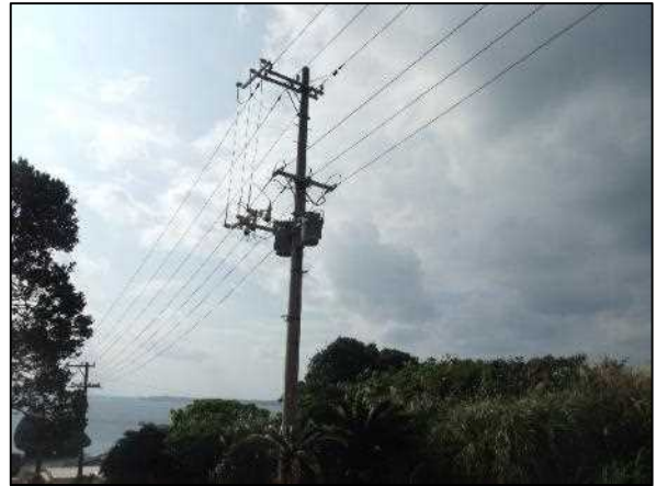
写真⑩ 柱上トランス
