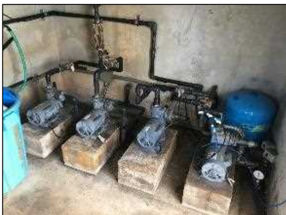
写真㉑ 水道用ポンプ
