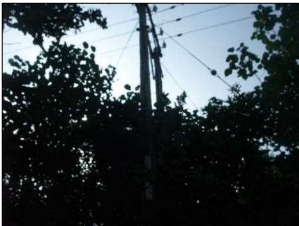
写真⑤ 高圧線ルート 3
