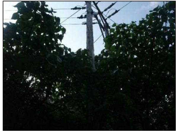
写真④ 高圧線ルート 2
