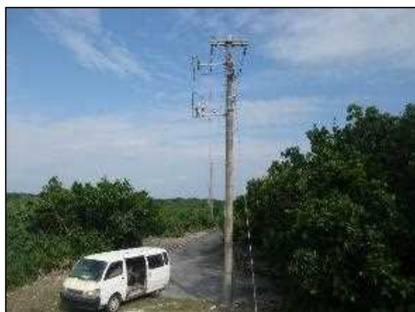
写真⑪ 高圧線端
