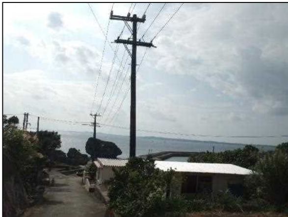
写真⑨ 高圧線ルート5
