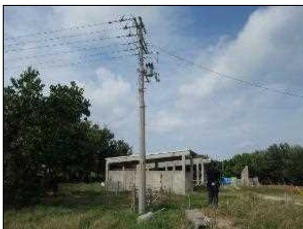
写真⑰ 畜舎前柱上トランス
