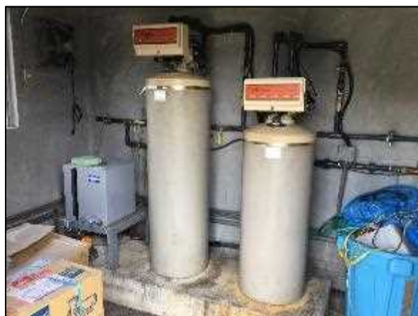
写真⑳ 水道用浄水
