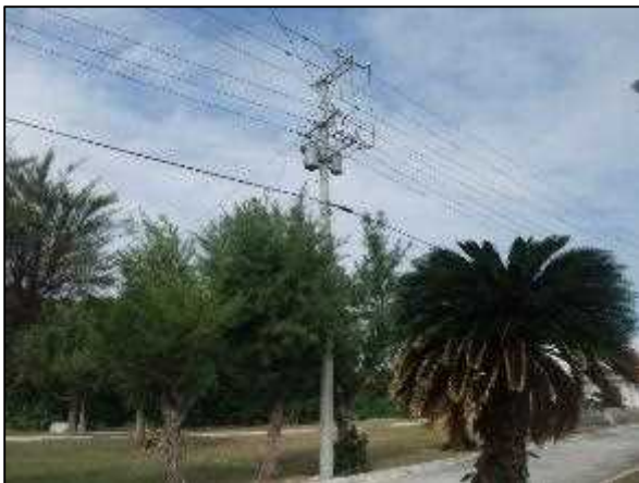
写真⑤ 柱上トランス
