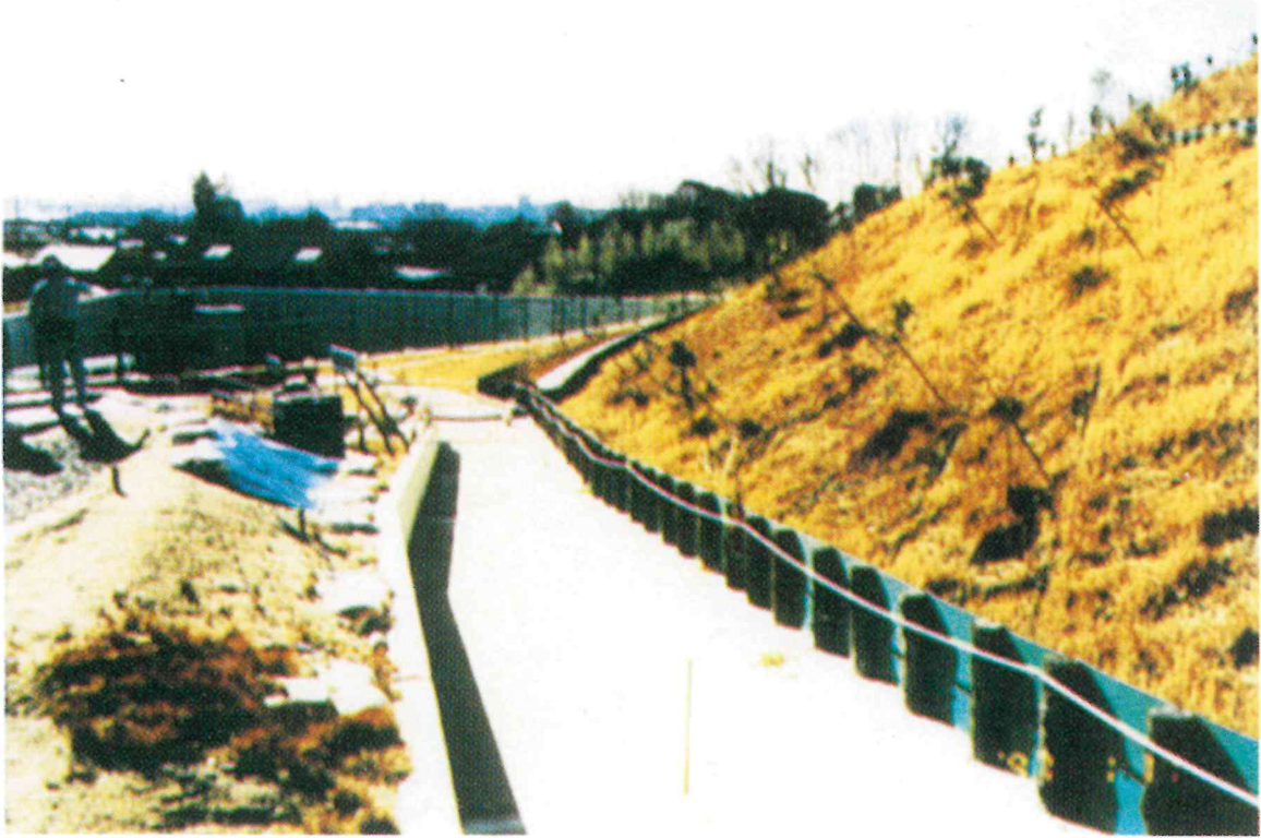
種子吹付工、柵工、場内仮設排水路 (本設と兼用)の組み合わせ
