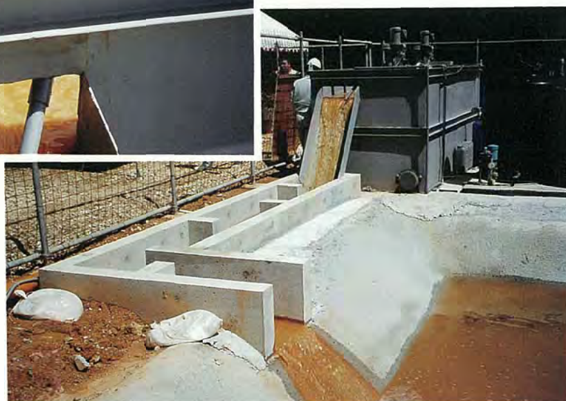
高分子凝集剤添加及び 攪拌水路
