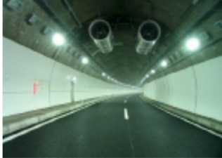
視野誘導するアクセント照明 と照明パネル
