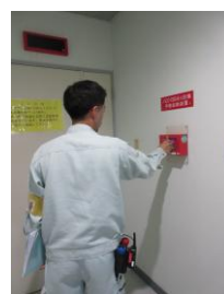
ガス消防設備の点検
