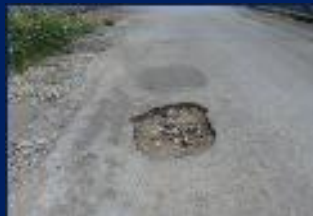
①路面の穴ぼこ・段差
