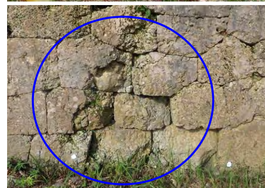
変状箇所の状況写真
