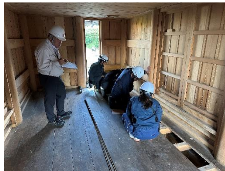
久慶門櫓変状調査
