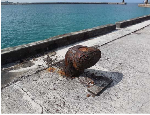
錆びた係船柱
