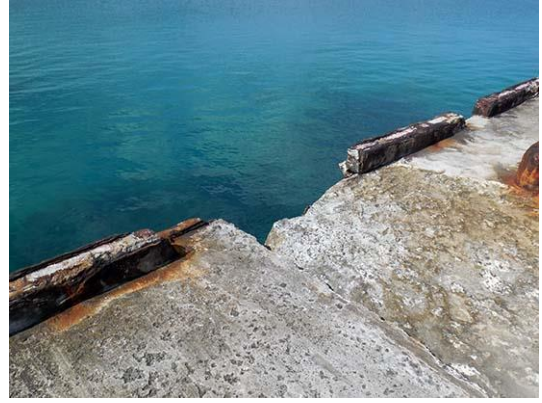
護岸のコンクリートが剥離している
