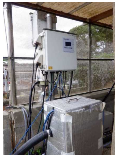
BOD監視システム
