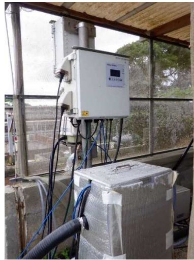
BOD監視システム
