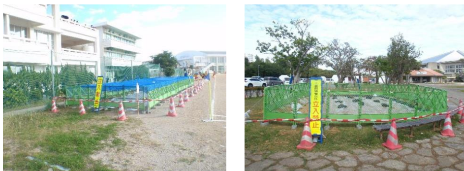
設置した保安施設
