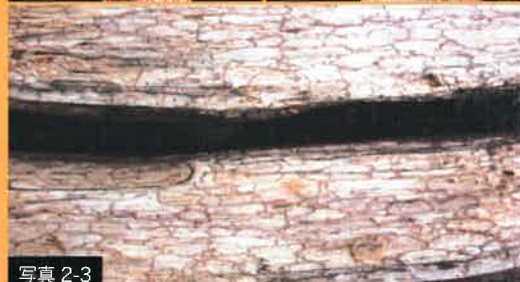
写真2-1～2-3 蜂の巣状の様相を呈した腐朽材
