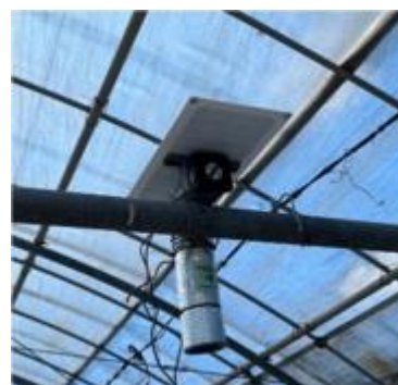
写真11 Wi-Fi利用したモニタリング機器の設置により、高温時、低温時にアラートで知らせ、ビニールハウス開閉の目安にする。
