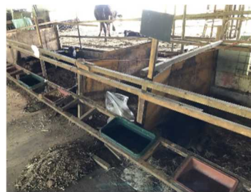
写真1 老朽化したカーフハッチ
