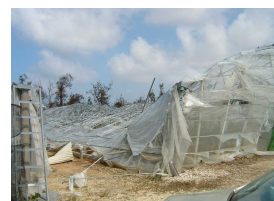
園芸施設の被害
