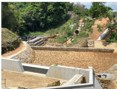
赤土流出防止と耕土の 保全循環を目指した施設
