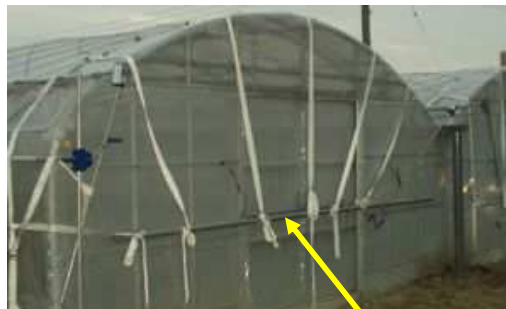
ハウスの出入口や天窓、谷間部分は補強材でしっかりと固定する。
