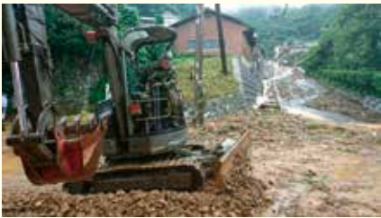
▲災害発生時に、自衛隊による様々な復旧活動が行なわれています。写真提供:防衛省ホームページ
