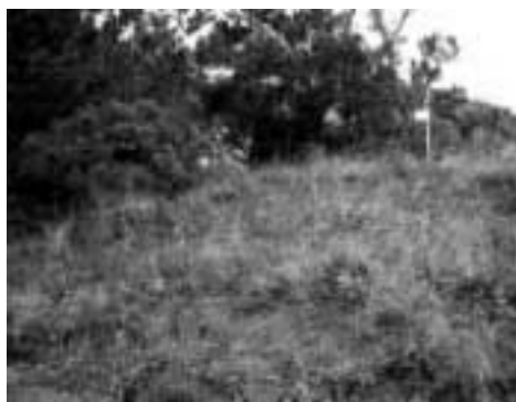
図4．地点⑤．法面に裸地部分が存在する。
