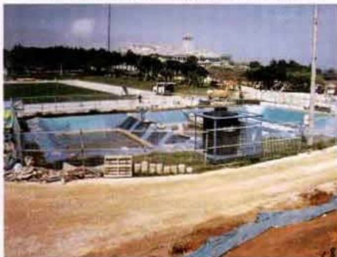
公園整備事業 濁液注入装置がついた沈砂池
