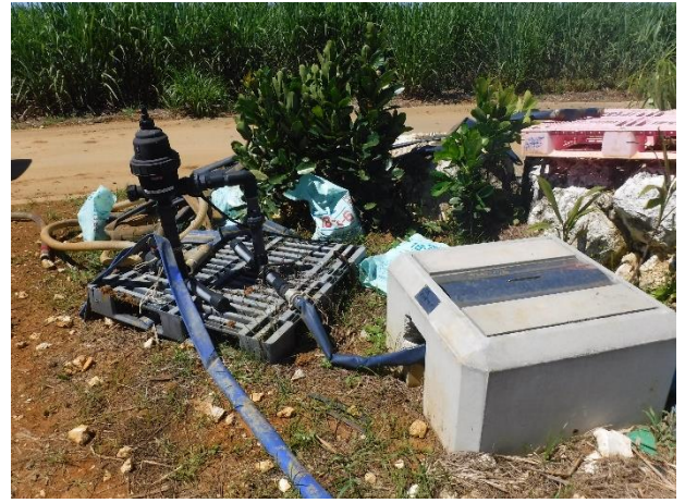
給水栓 (北大東島)
