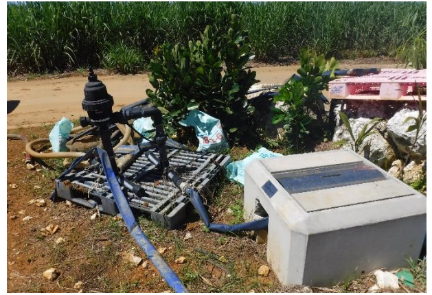
給水栓（北大東島）
