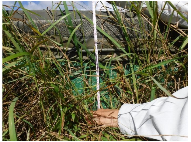
周囲に土が盛り上がり、低くなっている箇所 (左写真のマリンタンク)
