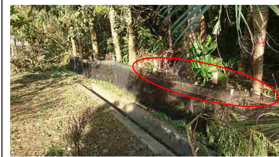
東側の粘着トラップの消失・破損
