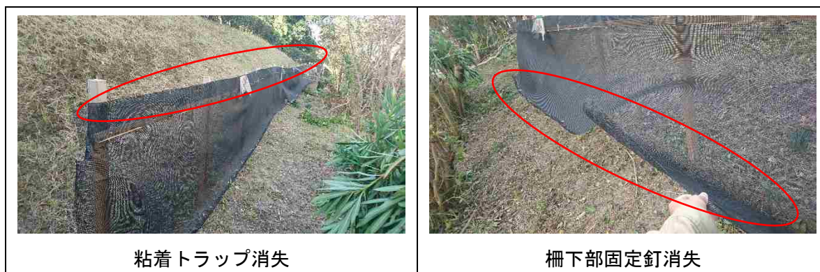
写真 3-1-6.4 台風 24 号による被害状況（直線①）
