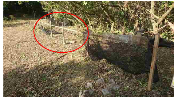
トリカルネットの消失・破損
