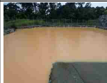
⑱ 沈砂池の状況 (オーバーフロー有り)
