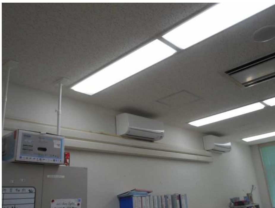
室内には2台の壁掛型FCUを設置(2kw級×2)
