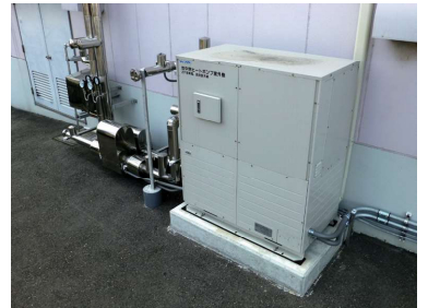
地中熱ヒートポンプ（室外機）
