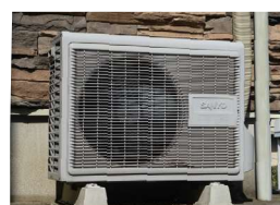
空気熱源ヒートポンプ
