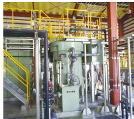
凝集沈殿処理設備
