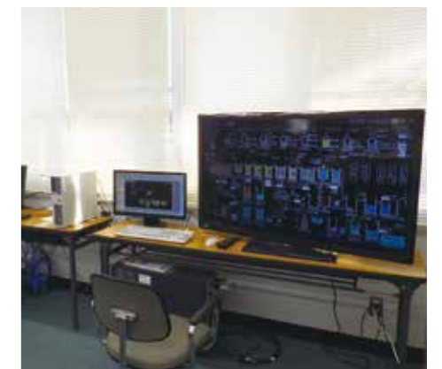
中央監視システム
