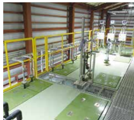
生物処理設備
