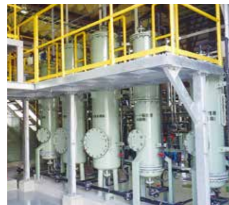
高度処理設備
