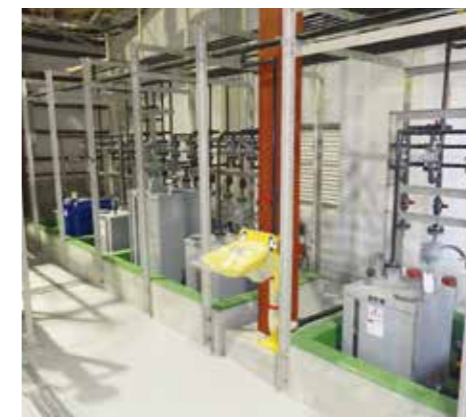
薬品注入設備
