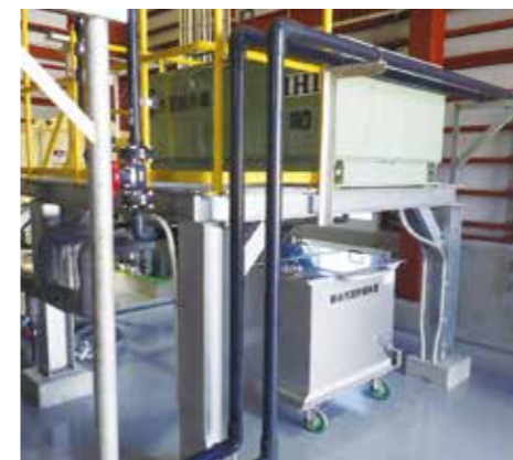
汚泥処理設備
