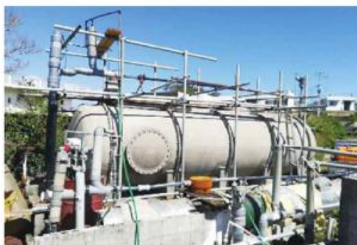
図3 県産技術を活用した10m 3 メタン発酵槽
