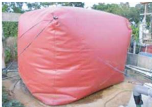
図4 バイオガスを貯蔵する10m 3 ガスバッグ
