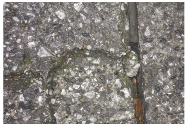
床のひび割れも食中毒菌や害虫がはびこる原因になります。
