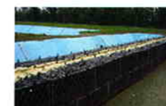
ろ過沈殿方式によるろ過機能施設
