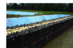
ろ過沈殿方式によるろ過機能施設
