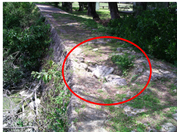
天端被覆工における変状例 (植生の異常、沈下・陥没) 中城湾港海岸富祖崎地区
