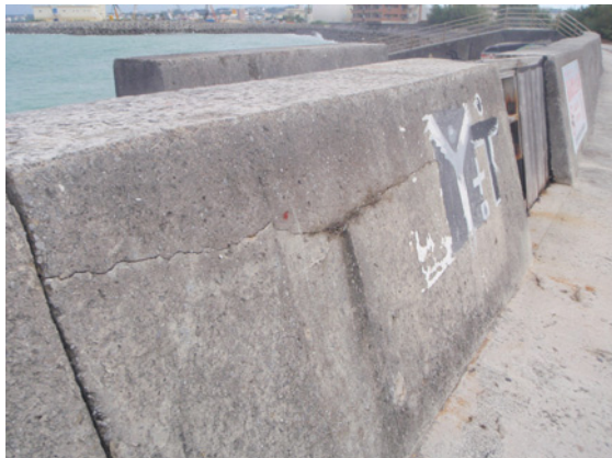
ひび割れ事例
