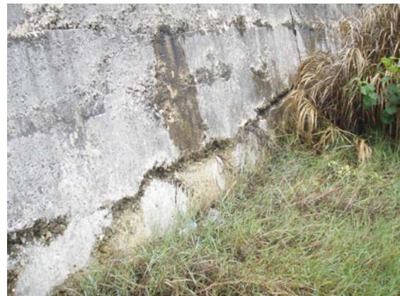
コンクリートの剥離・剥落事例
