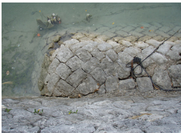
写真 6.2.6 根固工の石材の抜け (桃原漁港海岸)
