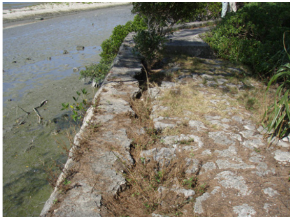
写真 6.2.3 天端被覆工の沈下・陥没、石材の抜け (中城湾海岸佐敷地区)
