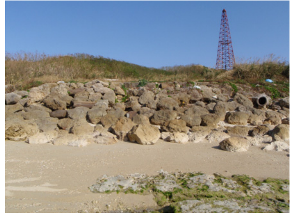
写真 6.2.2 表法被覆工の石材の抜け・ずれ (豊見城海岸瀬長島地区)
