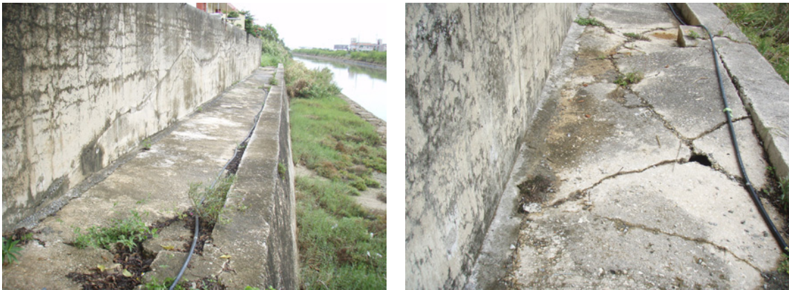
天端被覆工の変状事例(沈下・陥没)
