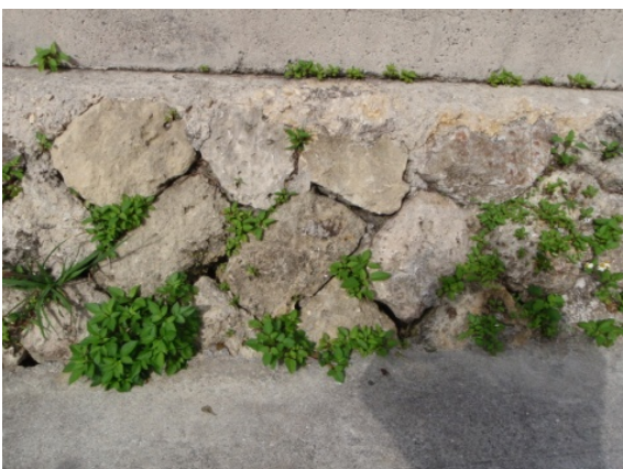
写真 6.2.5 裏法被覆工の石材のずれ (北谷海岸北前その1地区)
