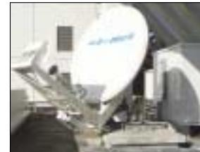
屋上アンテナ[衛星系] (教育ネットと設備共用)
