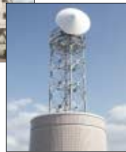
屋上アンテナ
