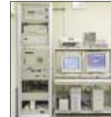
教育ネット設備
