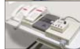
一斉受令電話機/ ホットライン電話/ 自動録音装置
