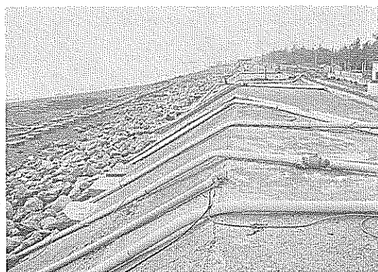
ハタ養殖場の取水口付近のパイプ群(東港)
