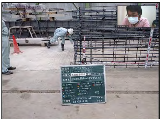
【立会状況画面（現場側）】
