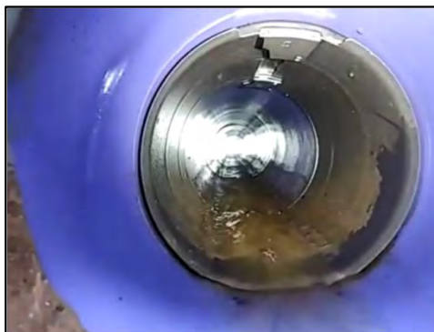
【オンライン検査（管の通り確認）】
