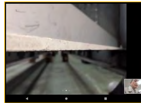
【鋼材の面取り処理】 カメラが寄っても確認しづらい
